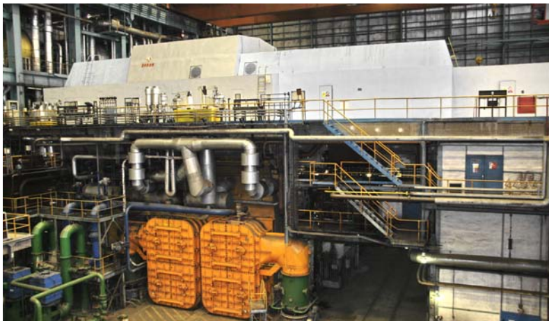
Pohled na turbosoustrojí a kondenzátor
